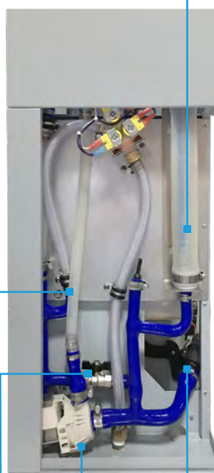
Pompe de drainage motorisée
